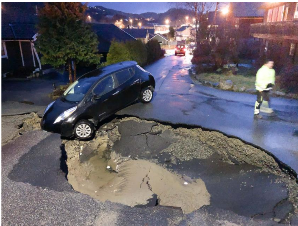
Figur 3. Ødelagt, eldre overvannsrør førte til synkehull i kommunen i 2019.
